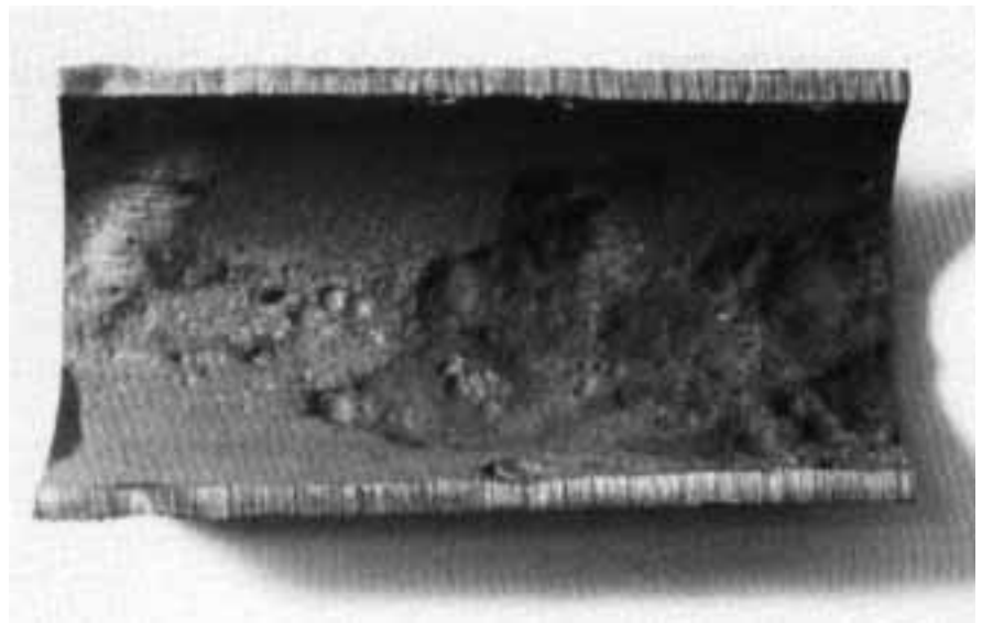
Ausgeprägte Mulden infolge Sauerstoffkorrosion in einem Rohr aus St 37 nach Entfernung der Korrosionsprodukte.
